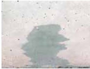
Grünlich-blaue Färbung einer Betonoberfläche drei Tage nach dem Ausschalen
