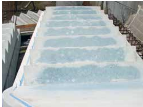
Betonfertigteil-treppe, die nach dem Ausschalen eine deutliche Blaufärbung aufweist
