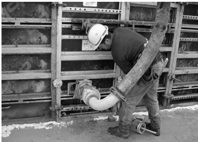
Bild 6: Science Center Wolfsburg: Einpumpen des Betons von unten in die Schalung (Foto: Doka; aus [10])
