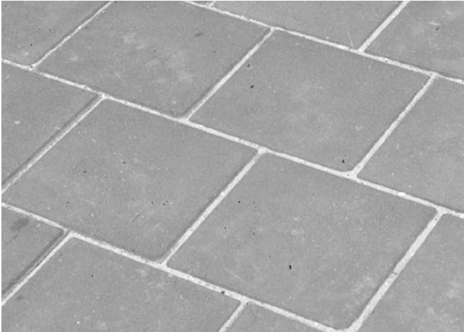
Bild 5: Ausblühungen nach einer Woche
