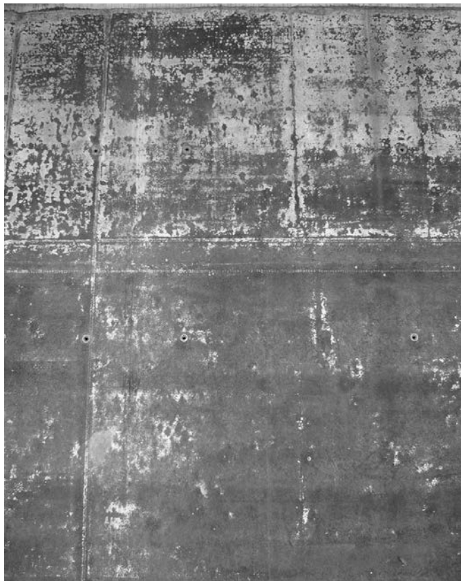
Bild 4: Ausblühungen an dunkler, im Winter betonierter Wandfläche
