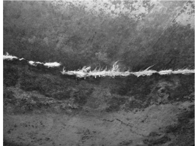
Bild 2: Aussinterungen an einem Deckenriss
