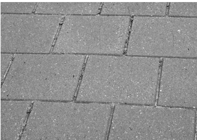
Bild 7: Ausblühungen nach 36 Monaten
