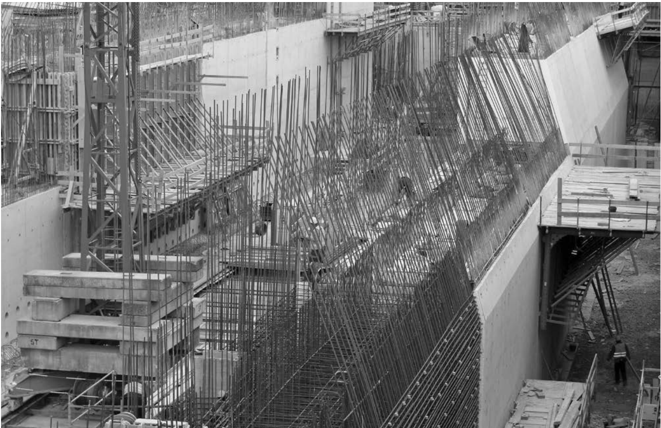
Bild 1: Massige Stahlbetonteile (Foto: A. Weisner)
