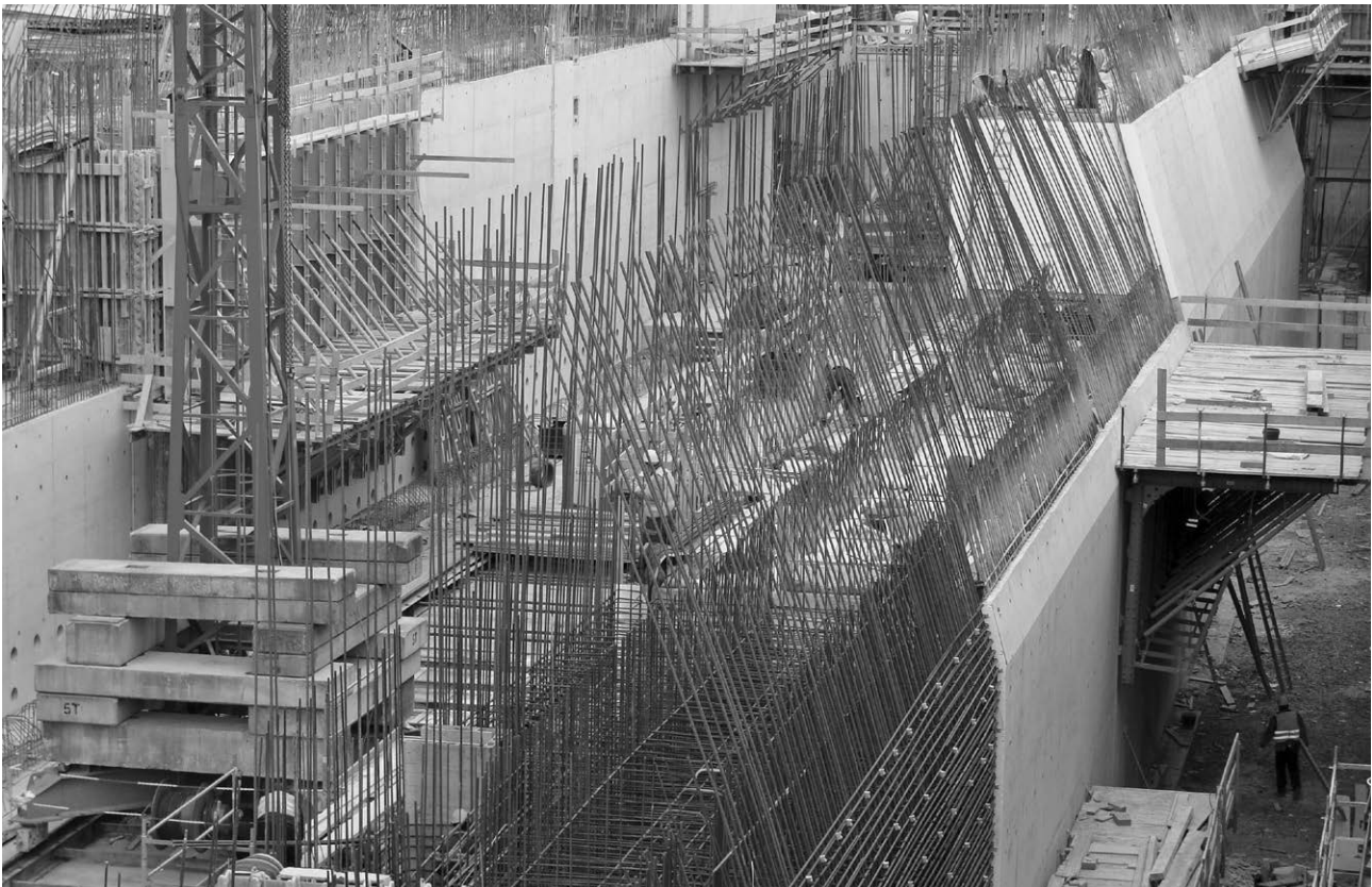
Bild 1: Massige Stahlbetonteile (Foto: A. Weisner)
