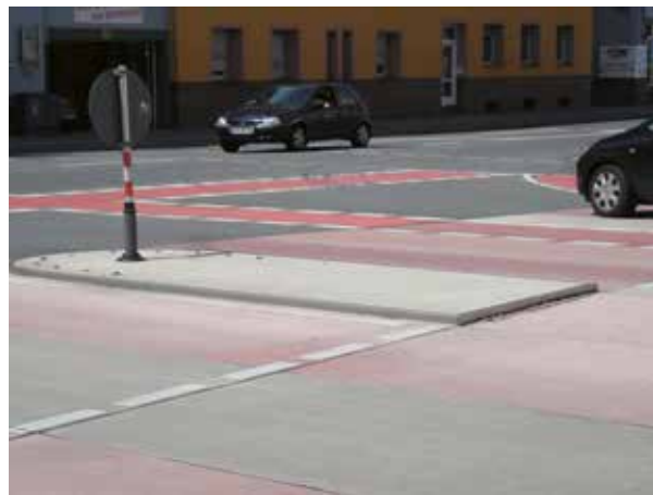
Abb. 10 Fahrbahnteiler mit Stahleinfassung
