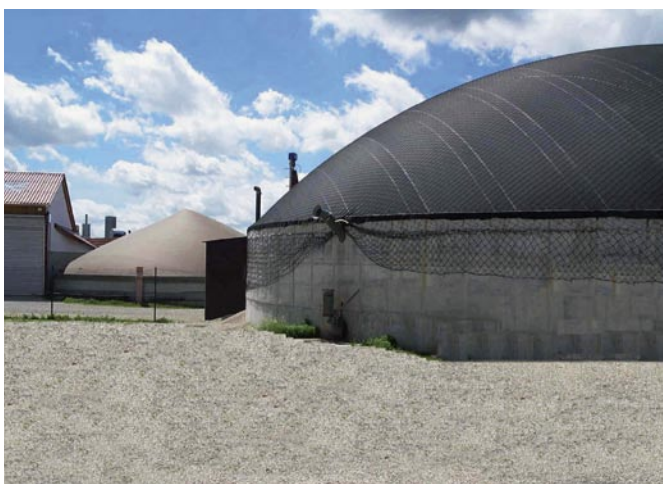
Bild 1: Das EEG schafft ab 2012 Klarheit für Investitionen in Biogasanlagen.
