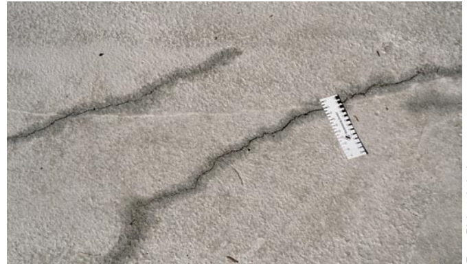
Bild 5: Rissbildungen durch unzureichende Nachbehandlung
