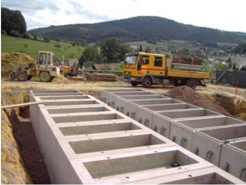
Kammersysteme aus Beton für Reihengräber bieten eine optimale Flächennutzung, Foto: Ackermann/Ökotec
