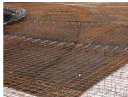
Bild 5: Bewehrung der Kreisfahrbahn mit Stahlschalung (innen) und Verdübelung der Querscheinfugen; weiß im Vordergrund: Betonstützschwellen
