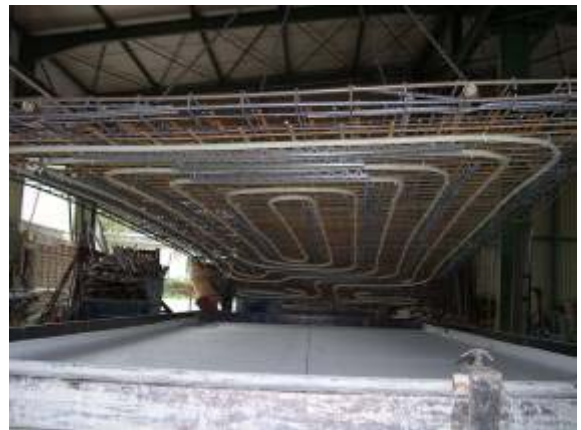
Abb. 8: Einlegen der vorkonfektionierten Bewehrung (mit Absorber und Abstandhalter) in die Stahlschalung auf die bereits eingelegte Dachfolie
